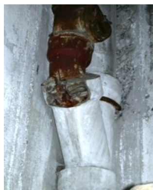
Ruptures de canalisation, fuites
